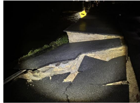
●北谷町吉原道路決壊 ・北谷町吉原で白比川氾濫し、北谷町吉原の道路が決壊 ※写真は、沖縄県中部土木事務所提供
